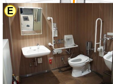
ドーチカ バリアフリートイレ オストメイト ベビーシート ベビーキープは一般トイレにあります。
